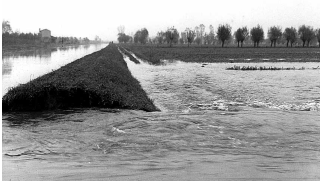
Figura 2-5: Alluvione del 1966 – Rotta del Canale di scarico a S.Margherita
